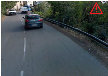
Glissières de sécurité en métal à éviter
